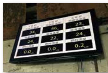
既存設備に増設可能
